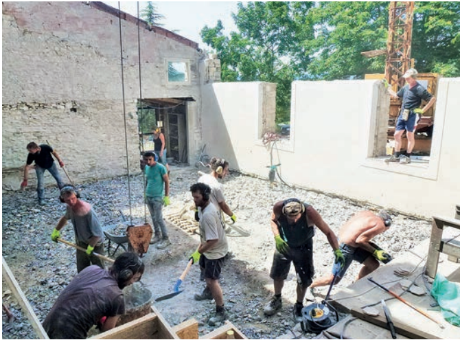
Der Saal von Grange Neuve im Juni 2017: Abbrucharbeiten – Tabula rasa für einen Neubeginn.
